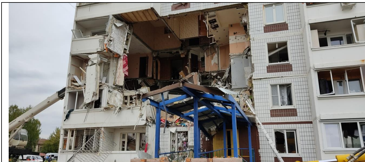
Рисунок Б.1 – Общий вид обрушения и повреждения конструкций жилых помещений с 1 по 5 этажи 2 подъезда здания в осях В-Г/4-6
