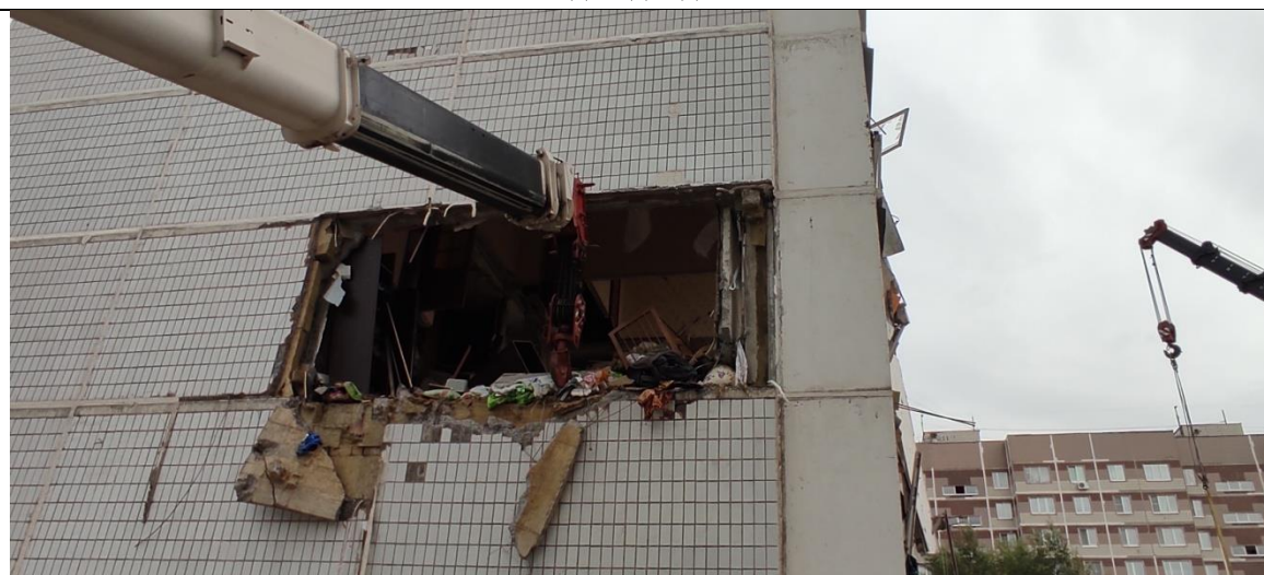
Рисунок Б.2 – Общий вид обрушения и повреждения конструкций жилого помещения на 3 этаже 2 подъезда здания в осях В-Г/6
