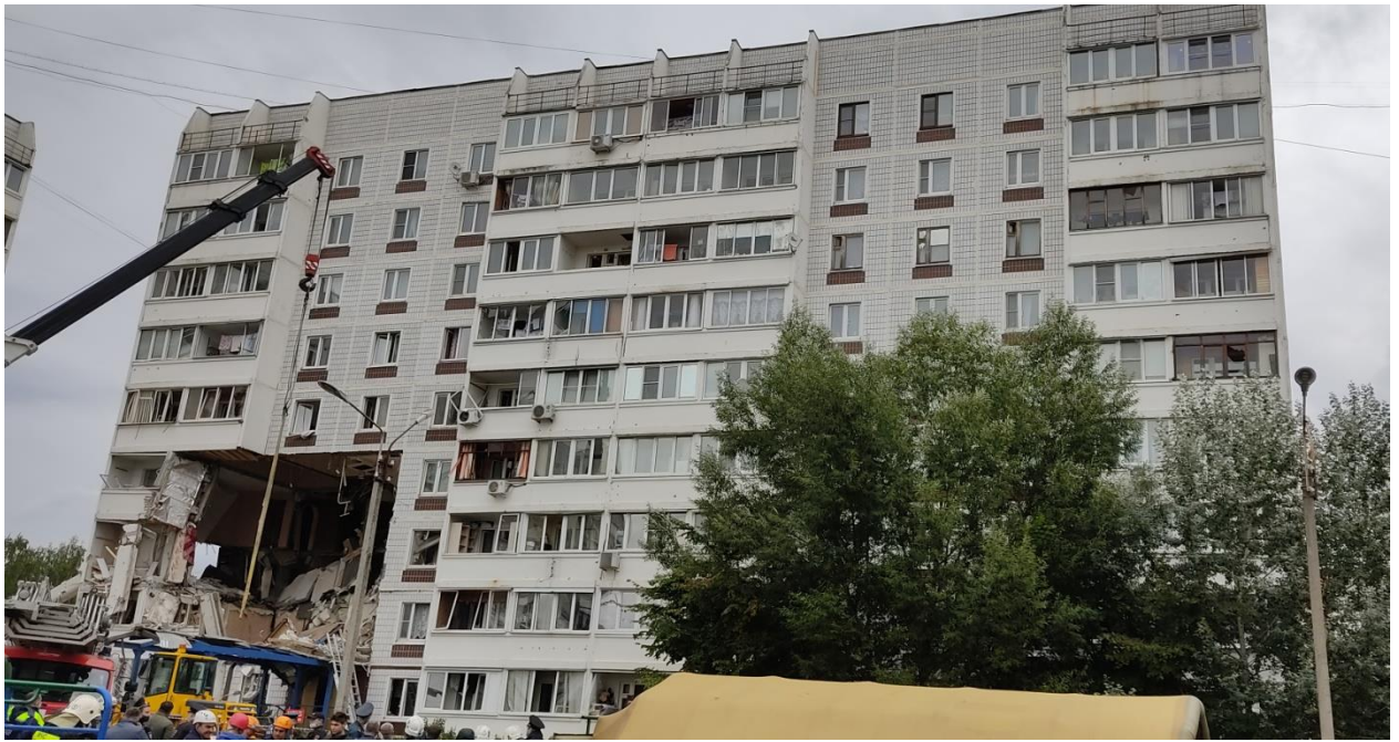
Рисунок 1.3 – Общий вид поврежденного фасада здания в осях Г/6-1
