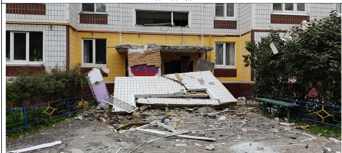
Рисунок Б.4 – Обрушенные конструкции лестничной клетки и фасада здания с 3 – 4 этажей 2 подъезда здания в осях Б/4-5
