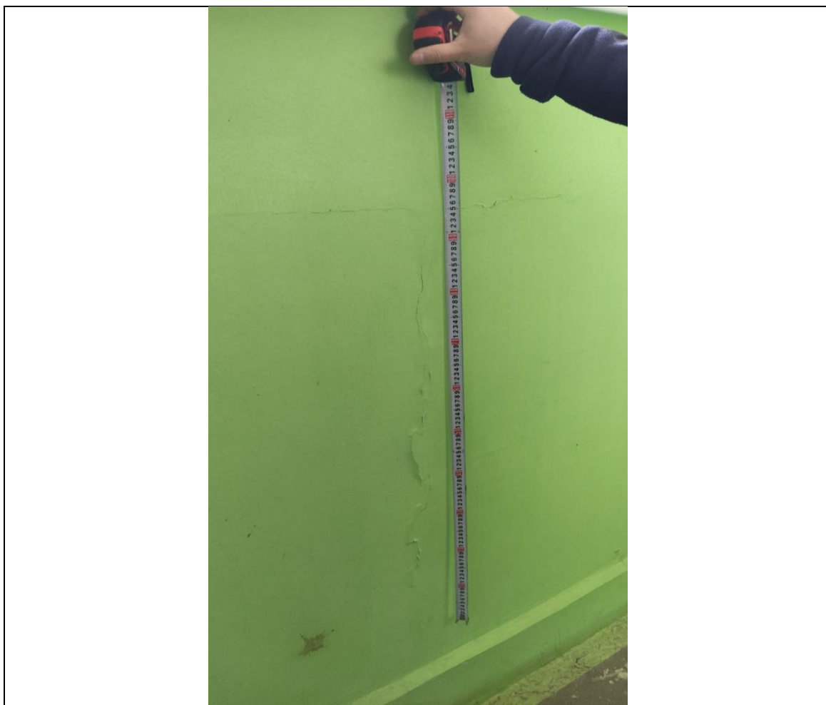
Рисунок Б.8 – Вертикальная и горизонтальная волосяные трещины на стеновой наружной панели на лестничной клетке м/у 2 и 1 этажами здания в осях Б/2-3
