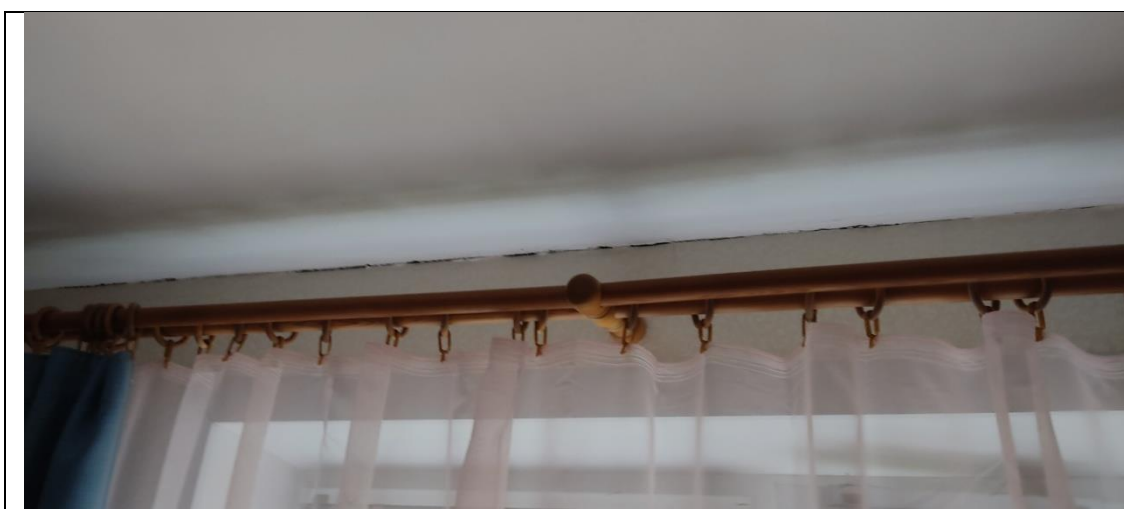
Рисунок Б.9 – Продольная трещина в месте сопряжения плиты перекрытия и стеновой наружной панели в жилом помещении на 3 этаже здания в осях А/4-3
