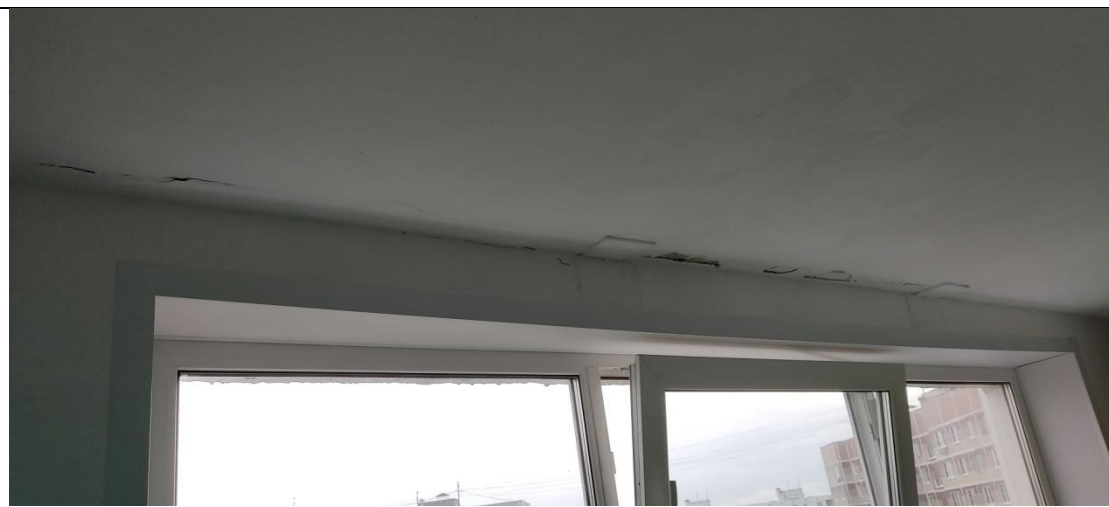
Рисунок Б.6 – Продольные трещины в месте сопряжения плиты перекрытия и стеновой наружной панели на лестничной клетке м/у 9 и 8 этажами здания в осях Б/2-3 (образование трещины после динамического воздействия на здание)
