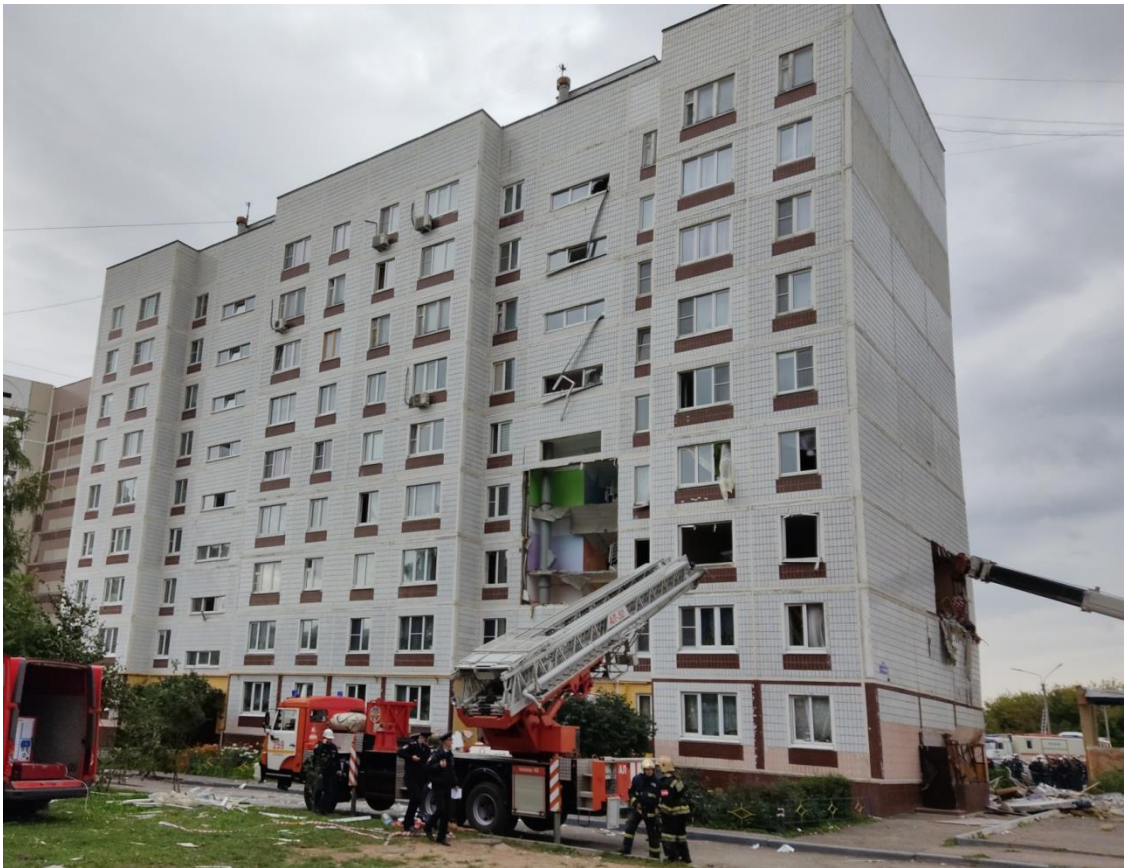
Рисунок 1.1 – Общий вид поврежденного фасада здания в осях А-Б/1-6 (схема здания с осями представлена в разделе 3, см. рис. 3.2.)
