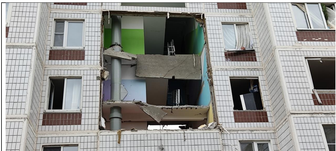
Рисунок Б.3 – Общий вид обрушения и повреждения конструкций лестничной клетки с 3 по 4 этажи 2 подъезда здания в осях Б/4-5
