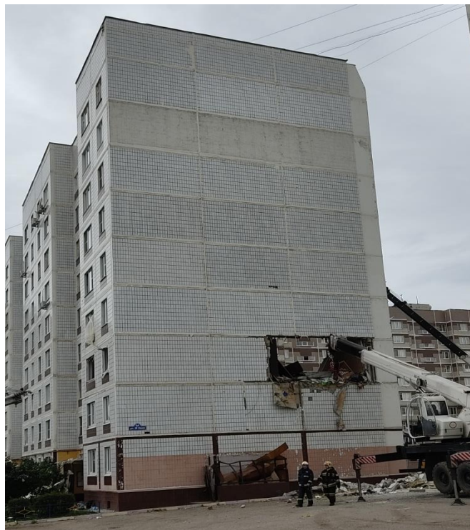
Рисунок 1.4 – Общий вид поврежденного фасада здания в осях А-Г/6
